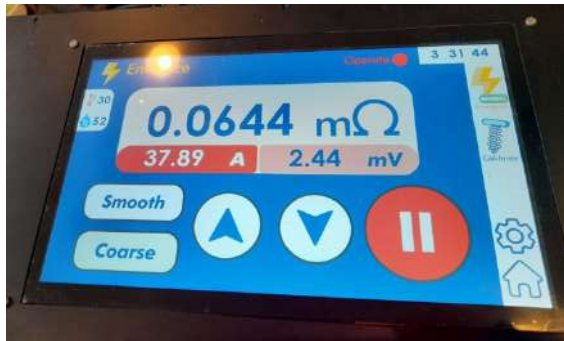
Gambar 6. Nilai tahanan kontak pada sambungan busbar 20 kV
