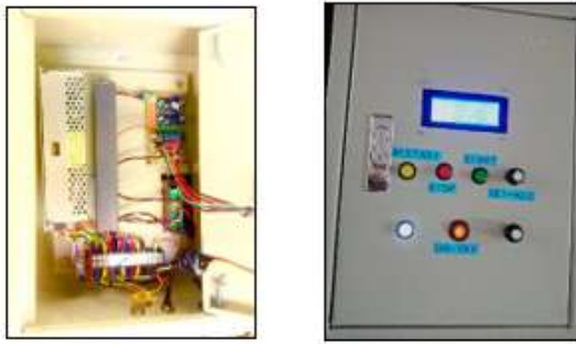
Gambar 8. Sistem Elektrikal yang direalisasikan; bagian dalam (kiri); bagian luar dan casing (kanan)
